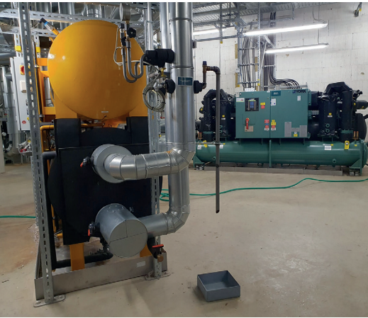
Kälteanlagenensemble der Kältezentrale im „Synus“-Gebäude des Karlsruher „GartenCarré“ (Abb. © Facor4Solutions)
